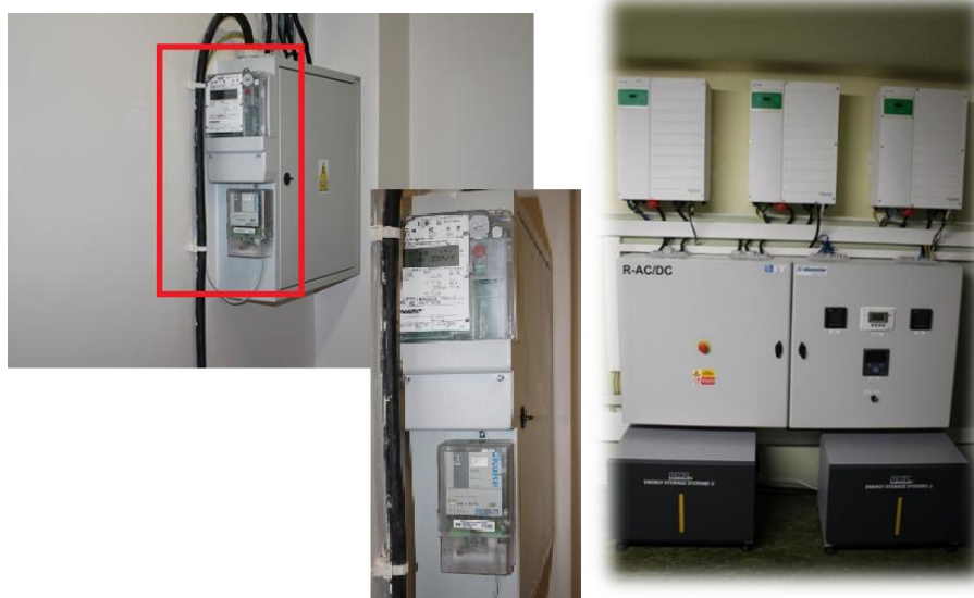
Obrázok 2 Skalár a elektromer inštalovaný v serverovni/merací bod situovaný v batériovom úložisku
