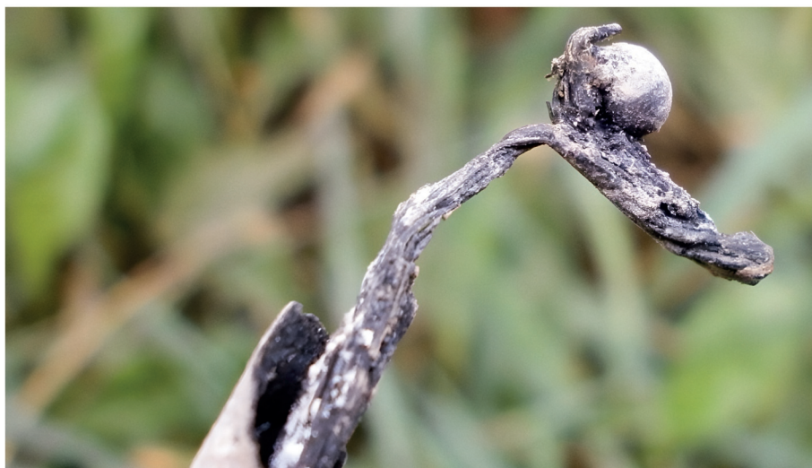
Porucha fotovoltického kábla uloženého v zemi (deštruktívny efekt pochádzajúci zo skratu a sformovaného elektrického oblúka)
