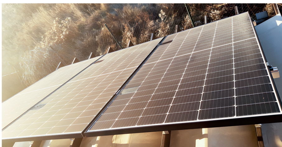
Príklad vizuálnej diagnostiky: Zatieňenie len nepatrnej časti fotovoltického článku pochádzajúce od montážnych svoriek a následný vznik hotspotu vygenerovalo dostatok tepla k roztopeniu námrazy povrchu celého panela
